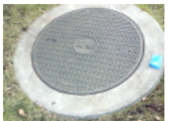
中防灰溶融施設入口わきにあるマンホール、ここから汲んだ排水が1.6 pg-TEQ/Lの値を示した。蓋に「雨水」とある。
